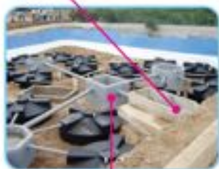
Receptor y Distribuidor de aguas residuales
