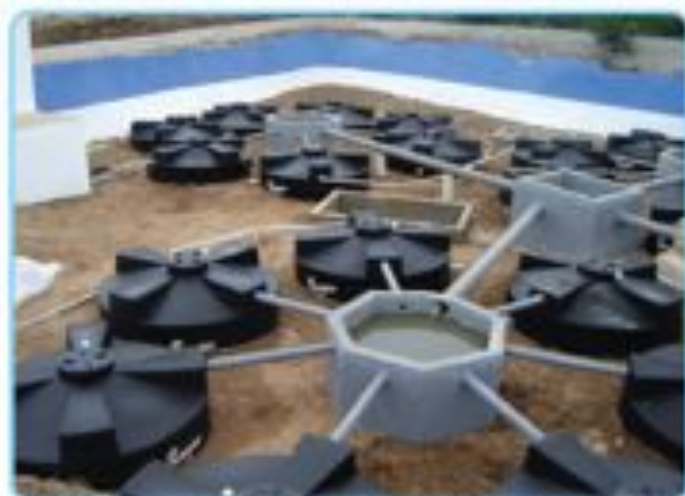
Bioplanta de Tratamiento Primario compuesta de 3 módulos
